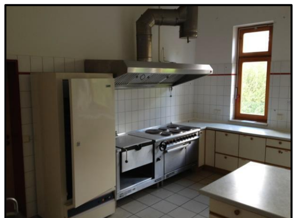
Voll ausgestattete Großküche
